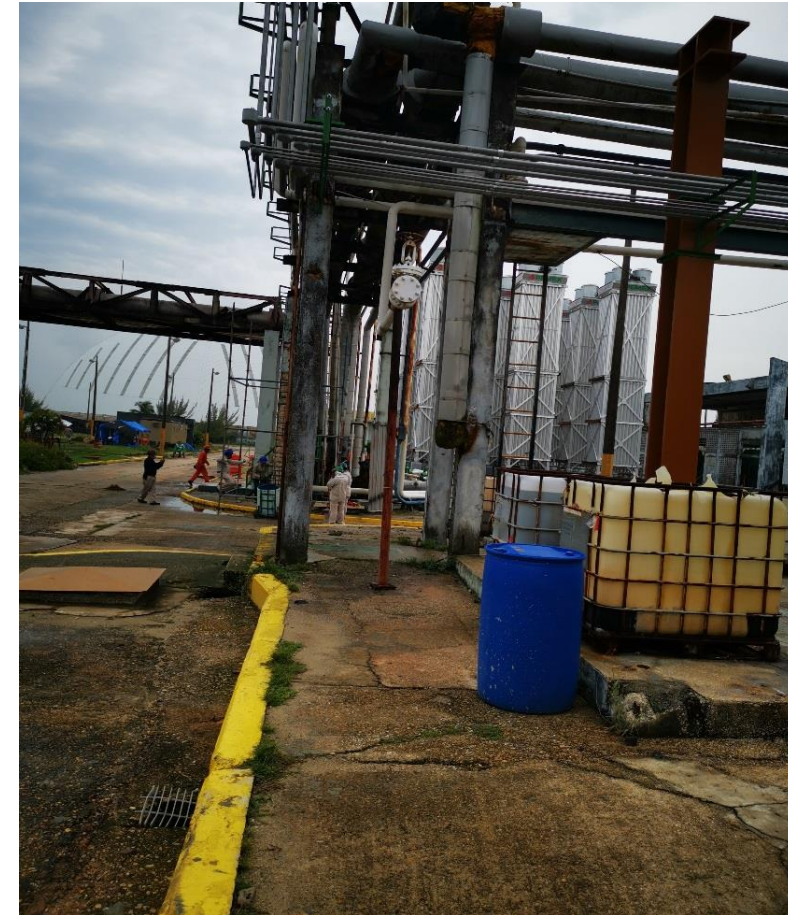
Tuberías de interconexión de etano
