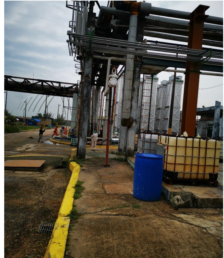
Tuberías de interconexión
