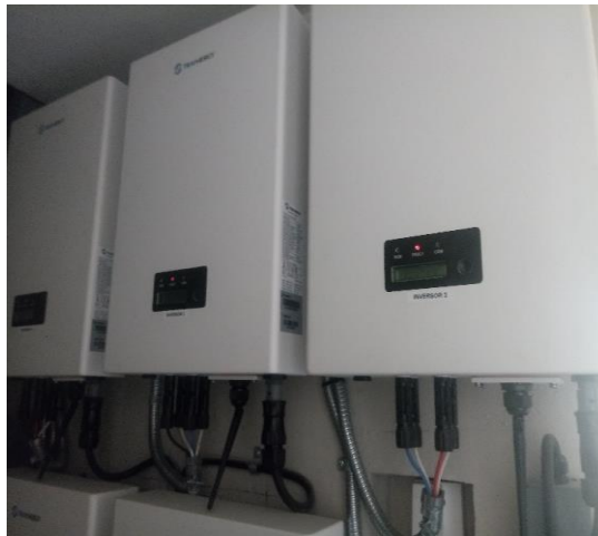
Generador interconectado. Elaboración propia.
